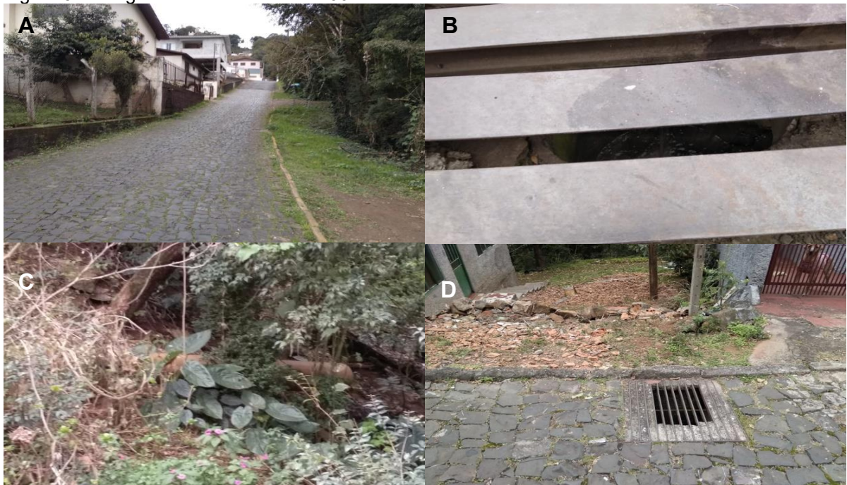
Figura 54: Imagens da Área Problema 06 – Rua Brandalise X Irmãos Melotto
